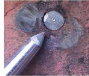
ਚਿੱਤਰ-26 ਟੁੱਟਿਆ ਹੋਇਆ ਬੋਲਟ
